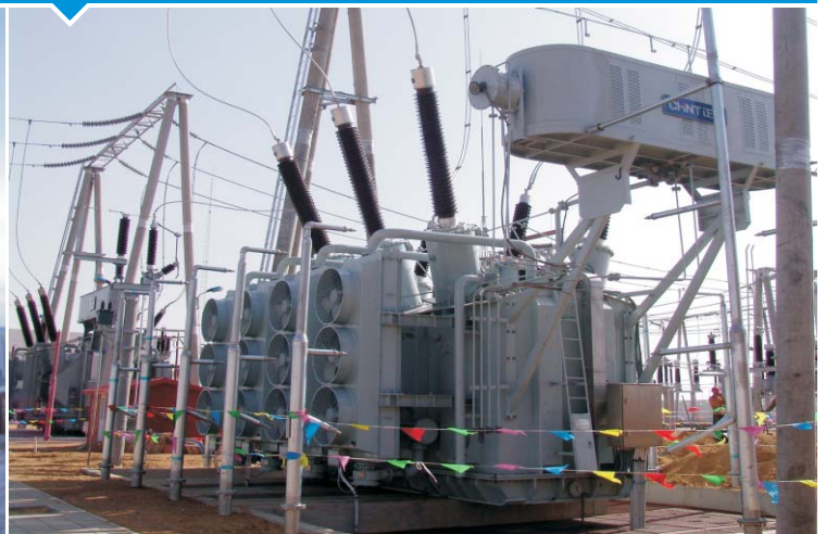
内蒙古电力 锡林郭勒温都尔2号主变 SFPSS10-150MVA 220kV
