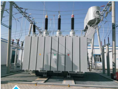
内蒙古电力 包苏木SSZ11-63000 110kV
