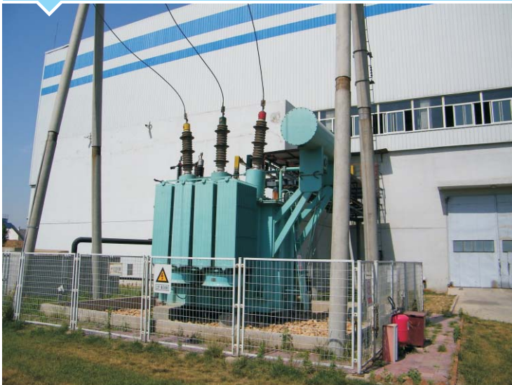
河北 邯郸国能威县秸秆电厂工程 SF9-40MVA 110kV
