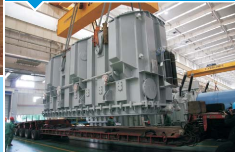
波多黎各 GEG项目 SFZ-570MVA 230kV
