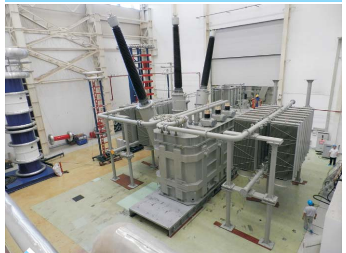
印度 2 × 350MVA MW 火电厂项目 SFZ-438MVA 420kV
