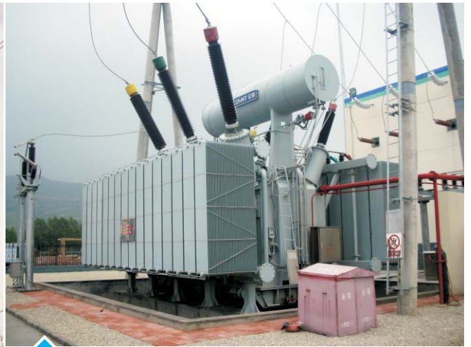
山西 神池南桦山一期 SSZ10-150MVA 220kV
