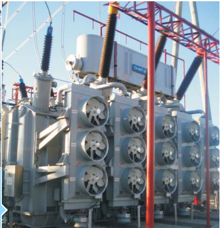
内蒙古电力 祥和站SFSZ9-120MVA 220kV
