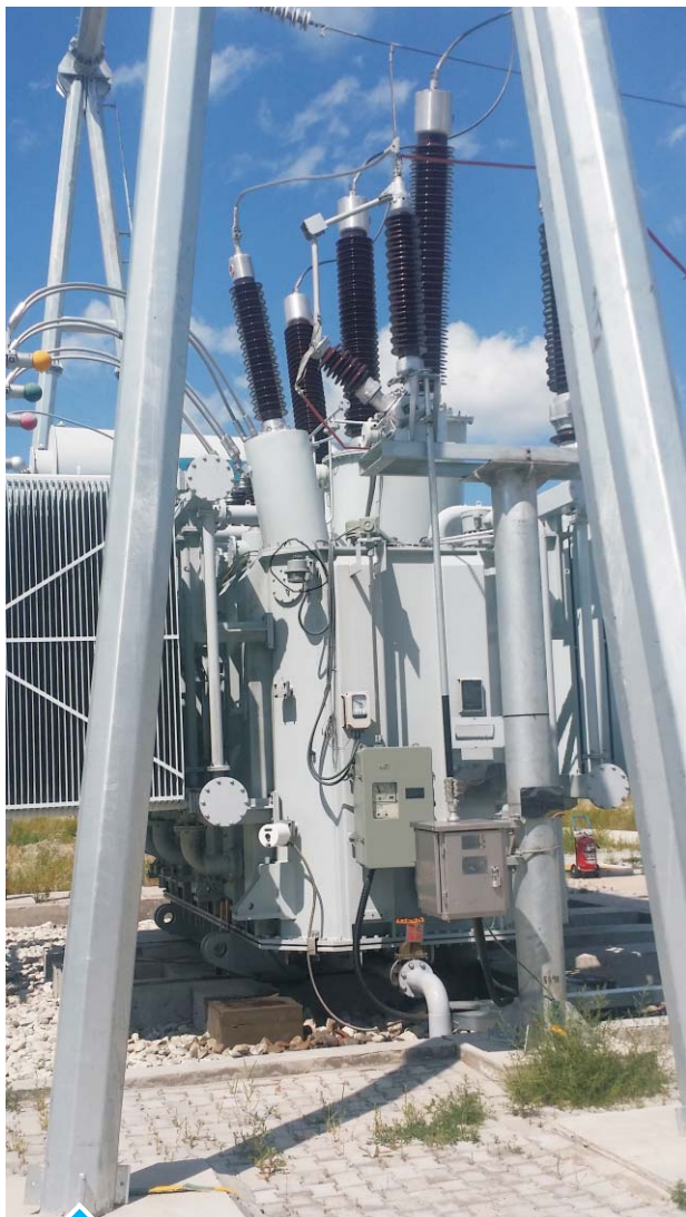
内蒙 华能满洲里东湖风电场 SZ10-100MVA 220kV
