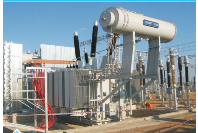
莫桑比克 275kV电站二期项目 SFZ9-45MVA 275kV
