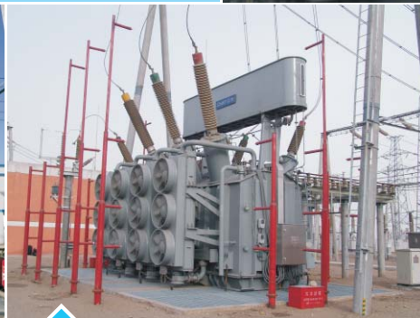
内蒙古电力 包头召庙2号主变SFPSS10-180MVA 220kV
