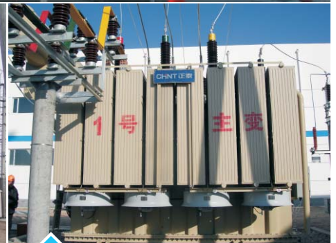
内蒙古电力 多伦站SFPSS9-120MVA 220kV
