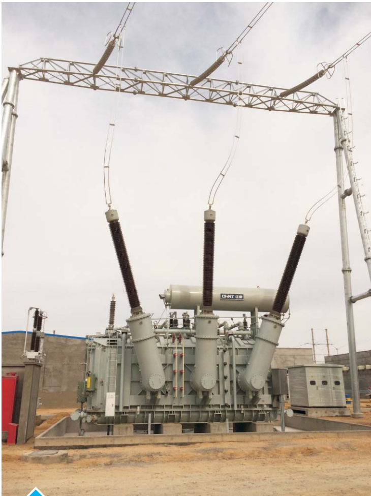
甘肃 中广核民勤风电场 SFPSZ11-240MVA 363kV
