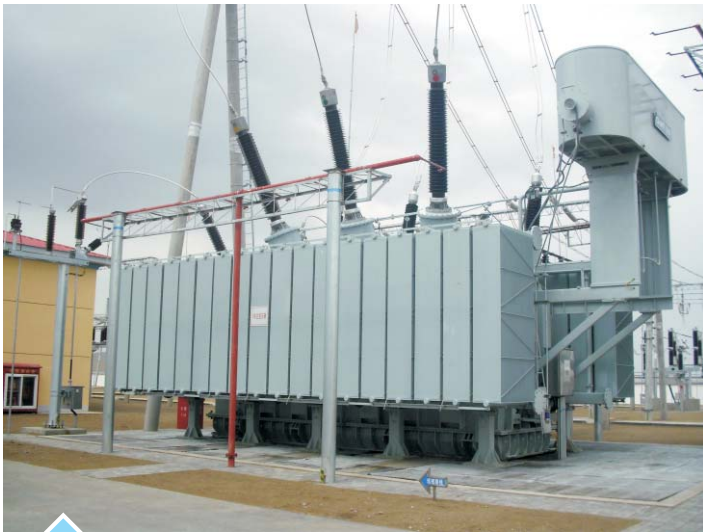
内蒙古电力 锡林郭勒五间房变电站 SSZ11-180MVA 220kV
