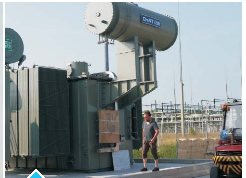
荷兰 KAD国网ALLIANDER项目SZ11-80MVA 150kV
