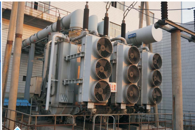
山东 邹平齐星开发区热电有限公司 SFP10-210MVA 110kV
