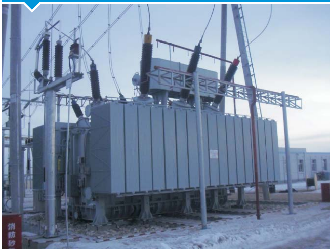
内蒙古电力 集宁北变电站SSZ11-180MVA 220kV
